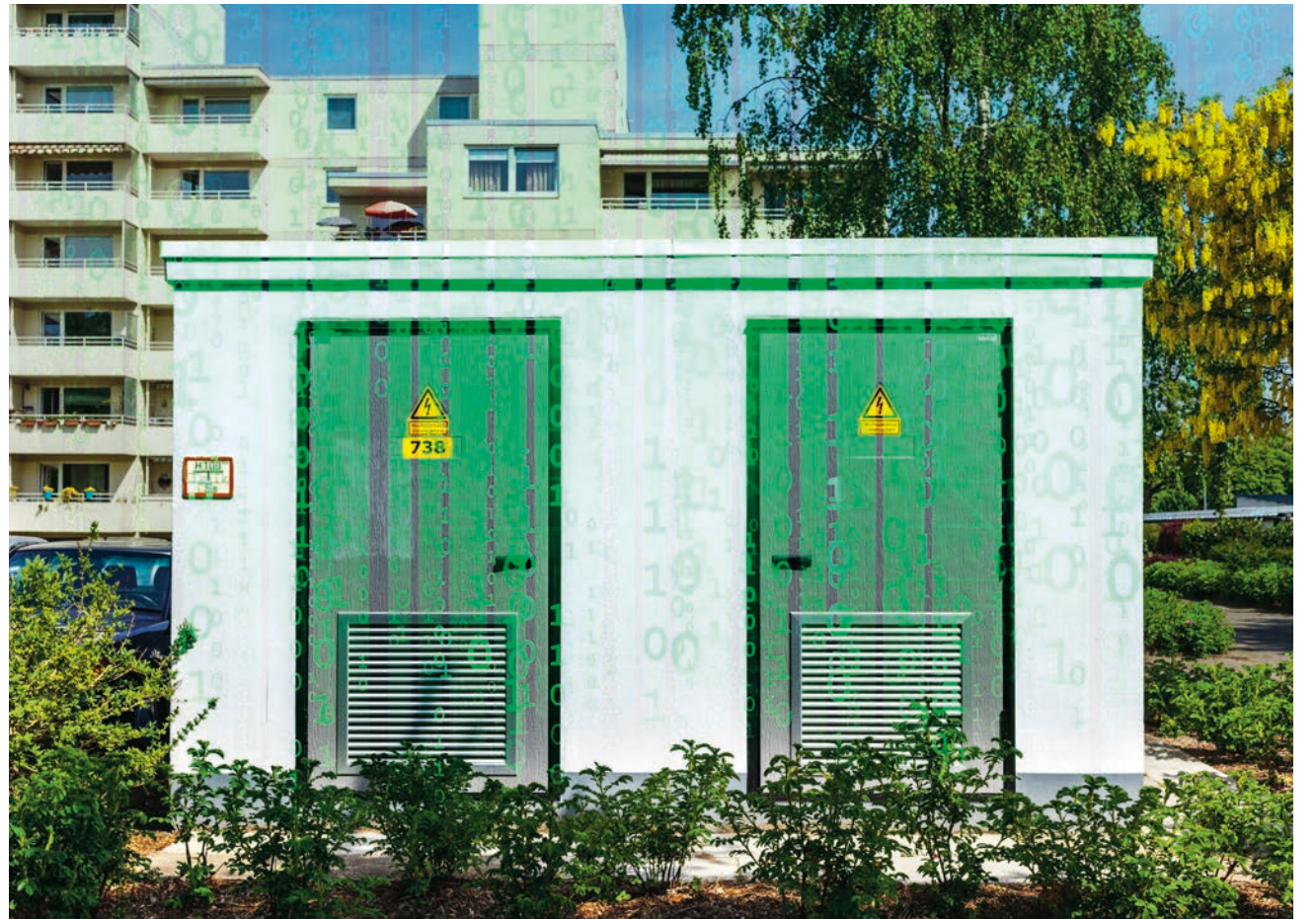
Partner des Projekts Ortsnetztrafo 4.0 sind Acal BFi Germany GmbH (Projektmanagement), Comtac AG (Elektronik und Trafo-Stations-Monitor), EPS Energy GmbH (Energiesmesstechnik) und Kumedica GmbH (Schnittstellen-Software). Bild: © detailfoto, Maksim Šmeljov/AdobeStock
